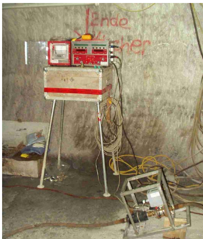
Bild 2 - Durchflussmesseinrichtung mit Steuer- und Registriereinheit
