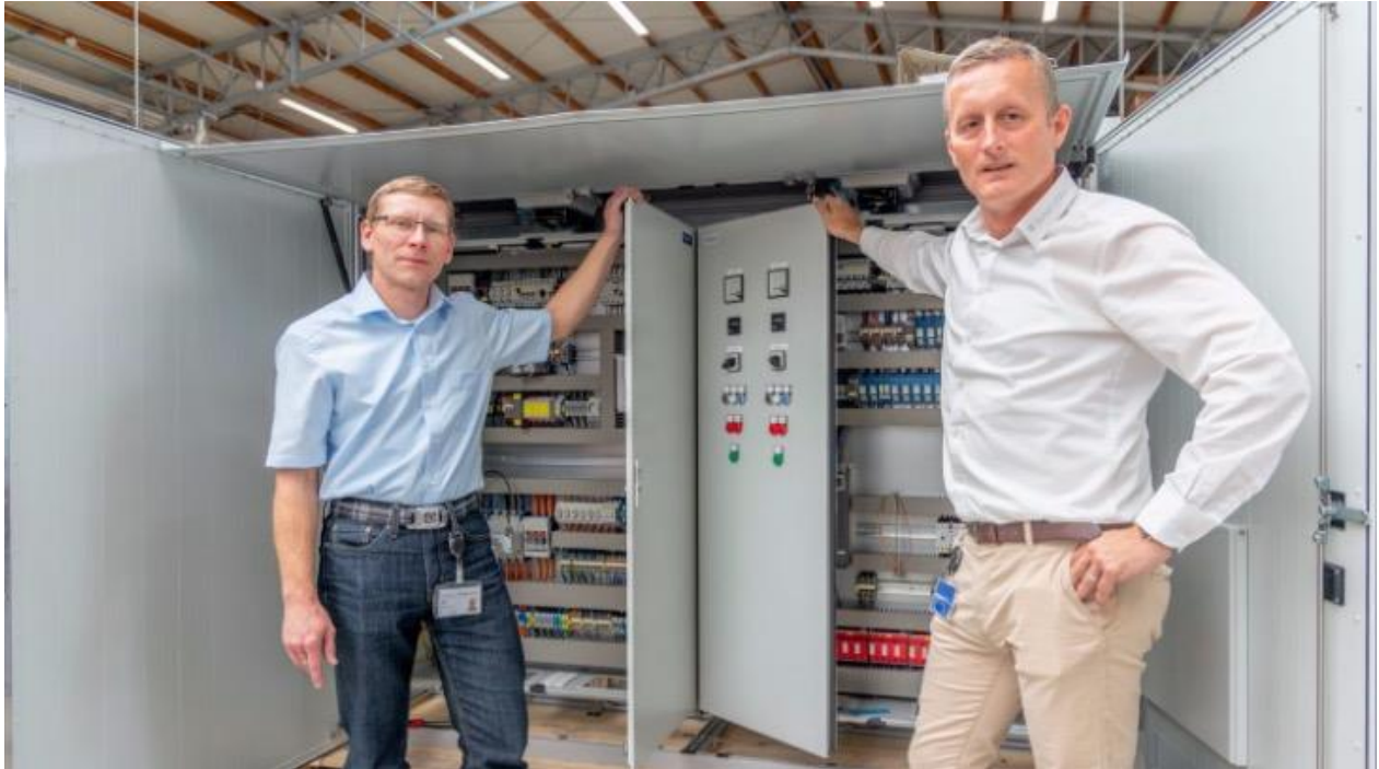
Steve Vogt (links) und Sascha Schröder am Schaltschrank - Fotos (2): R+S Group AG
